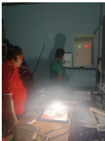
Gambar 4. Penempatan SCC, Panel dan baterai dan pengujian
